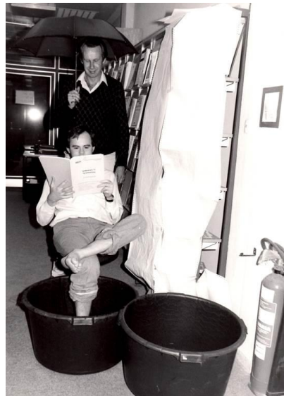
Sieghart: immer hilfsbereit, hier als Schirmherr. Das Flachdach des Gebäudes Wunstorfer Str. 14 war an manchen Stellen undicht.
